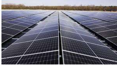
Gambar 1. Pembangkit Listrik Tenaga Surya
