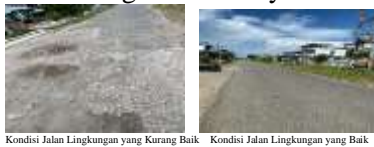
Gambar 6 Kondisi Jalan Lingkungan
