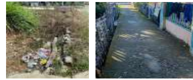
Saluran Drainase Lingkungan yang Belum Memiliki Drainase
